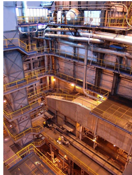
Parní kotel na uhlí v elektrárně Opatovice. Zdroj: Teplárenské sdružení České republiky
